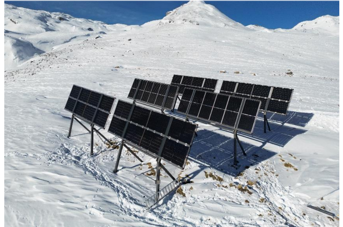
Nandro, eine von unseren insgesamt 3 Testanlagen (Quelle: ZENDRA, ewz)
