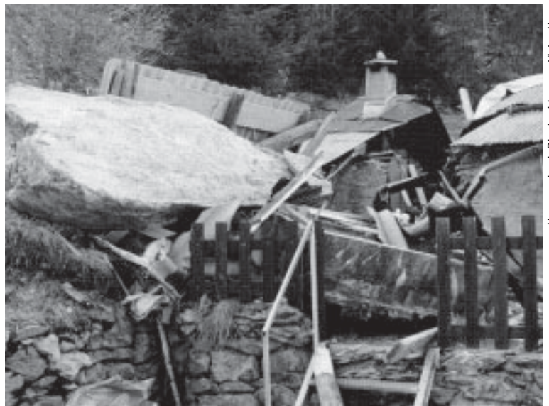
Henzen, durch Blockschlag zerstörtes Haus
