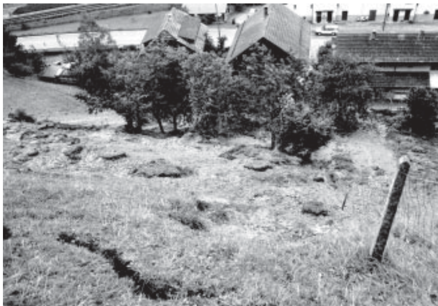
Kellerhals+Haeffel AG, gefährdetes Siedlungsgebiet
