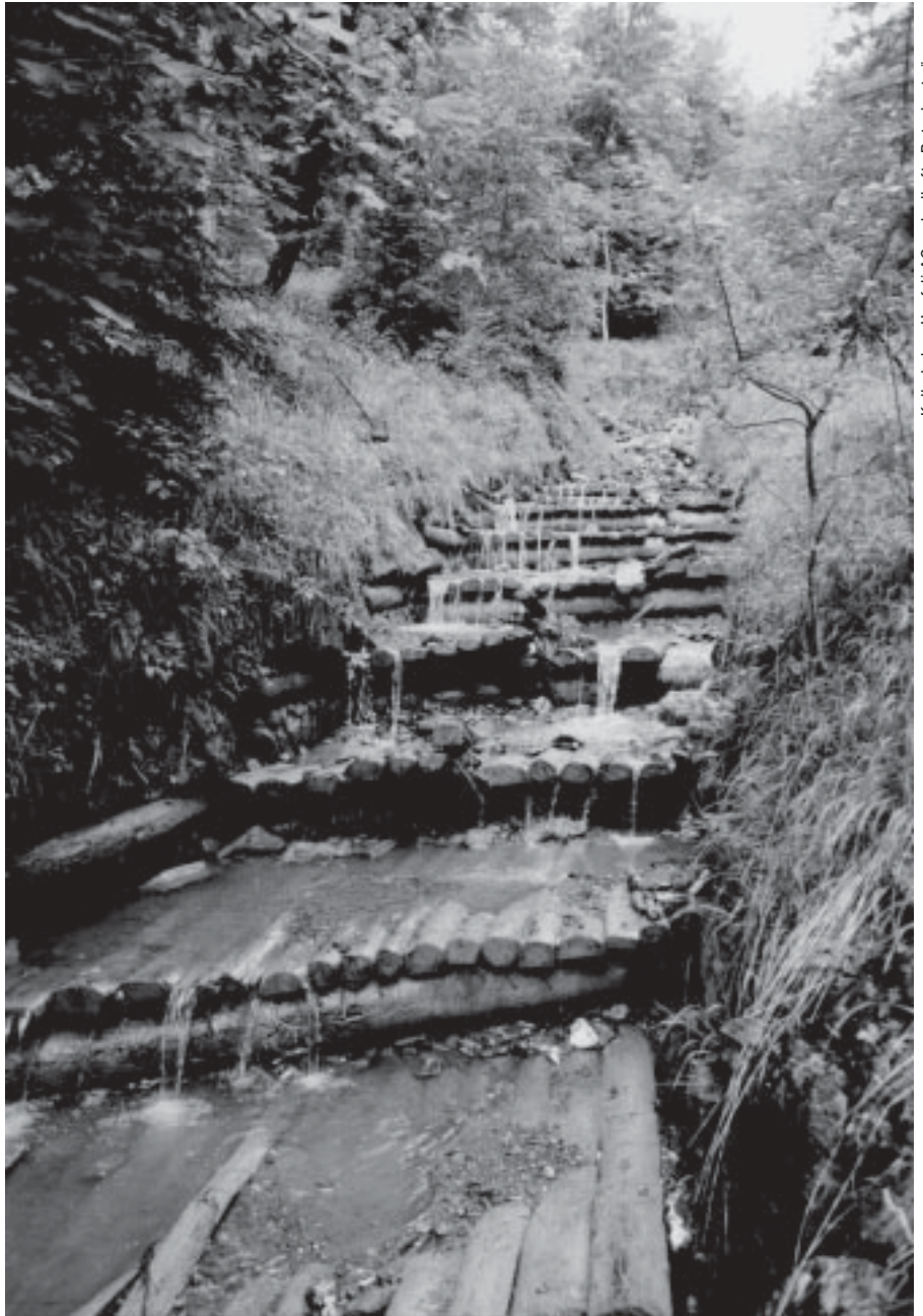
Kellerhals + Haefeli AG, schadhafte Rutschentwässerung
