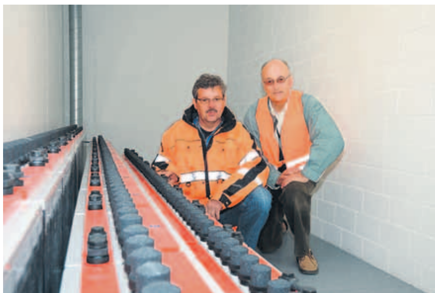
Jürg Frischknecht und Franco Isepponi vor der Batterieanlage.
