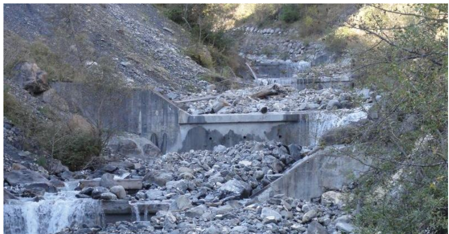
Bild 6: Sperrentreppe am Arieschbach im Gebiet „Geissegga“ (unterster Sperre im Bild eingekiest).
