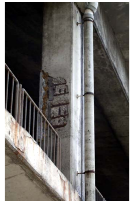
Schwer geschädigte Galeriestütze
